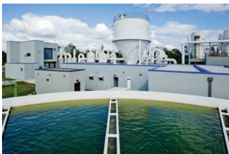
Agua potable y aguas residuales
