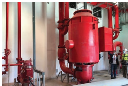
Protección contra incendios
